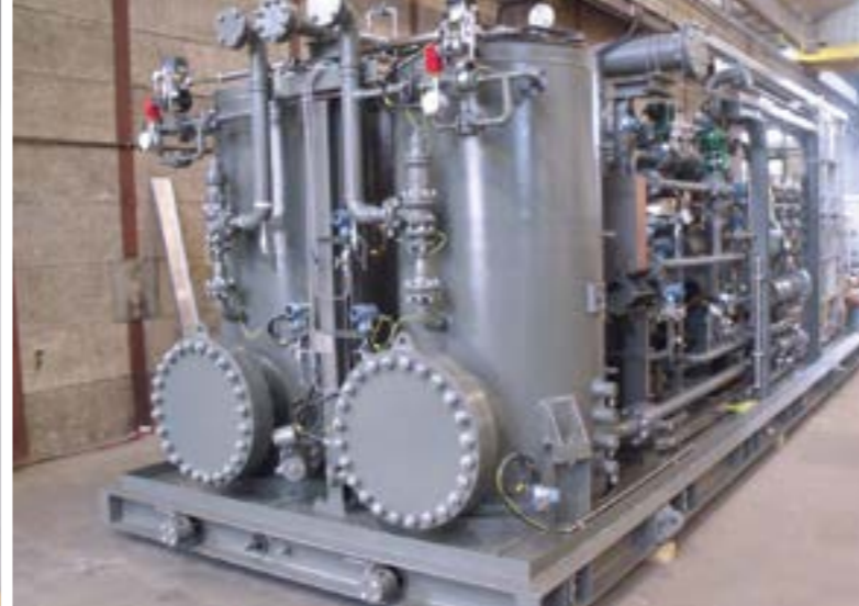
ДКС для подачи топливного газа в ГТУ. г. Щелково, Московская обл.
