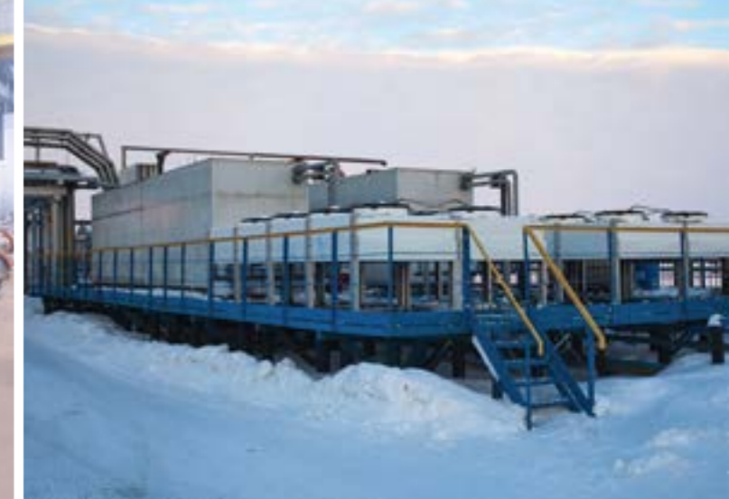
ДКС для попутного нефтяного газа. Тэдинское месторождение.
