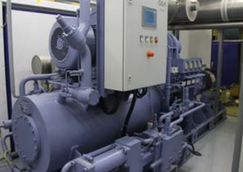
Установка охлаждения метана в дроссельном цикле ожождения. Санкт-Петербург.
