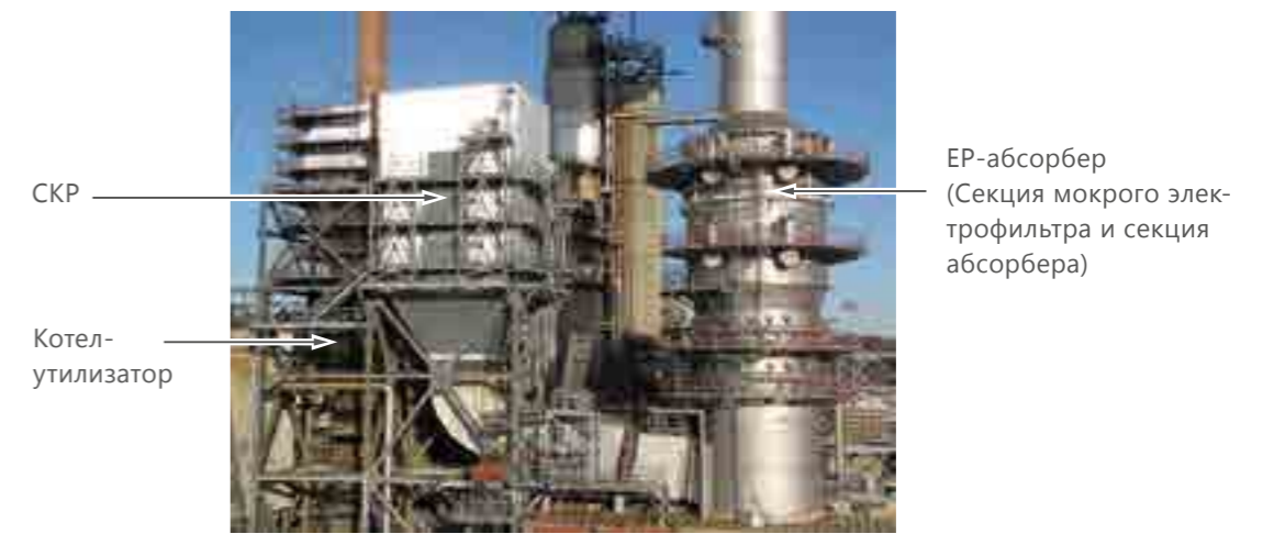
ПРИМЕР УСТАНОВКИ ГАЗООЧИСТКИ ДЛЯ ФКК: ЗАВОД CITGO, LEMONT (USA)
