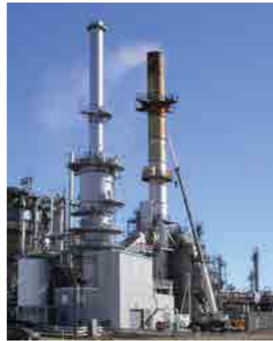
EP-Абсорбер с резервуаром для хранения кальцинированной соды, насосной станцией и пультом управления для нефтеперерабатывающего завода Tesoro Corporation (USA)
